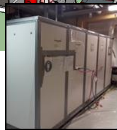
SAS de sortie personnel à 5 compartiments
